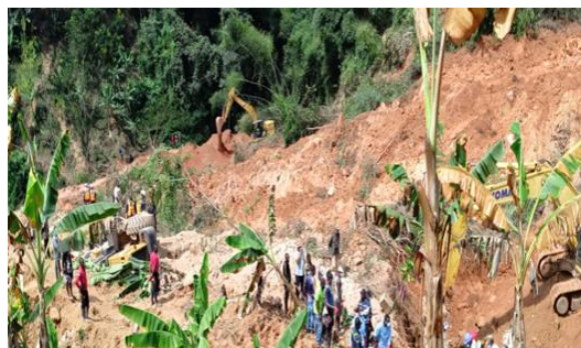
Photo 4 : Site de l'éboulement de la Falaise de Dschang
