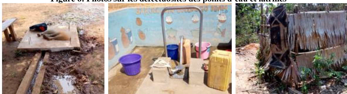
Figure 6: Photos sur les défauts des points d'eau et latrines
