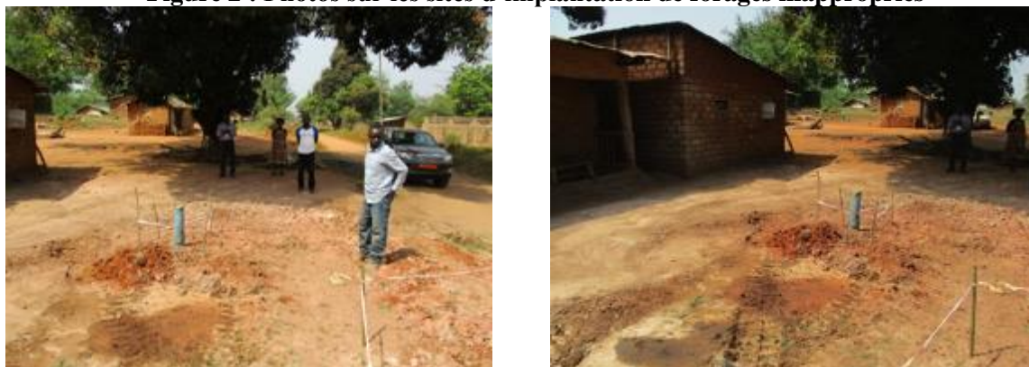
Forage implanté à moins de 20 mètres d'une route départementale et d'une habitation à Ngoura dans la Région de l'Est (Photo OSD)
